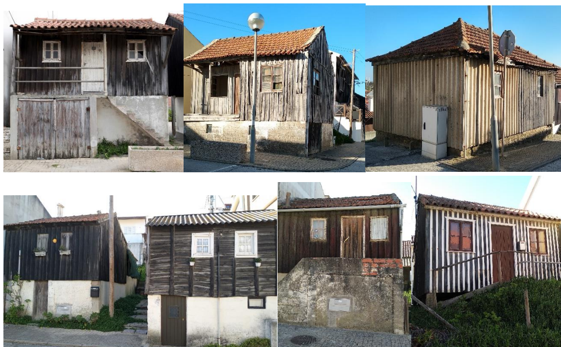
Figura 64. Construções com necessidade de reabilitação
