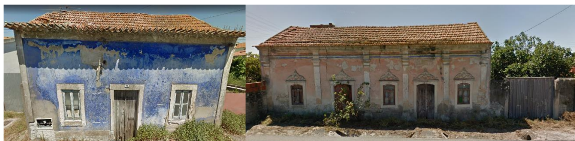
Figura 36. Casas Gandaresas com necessidade de requalificação
